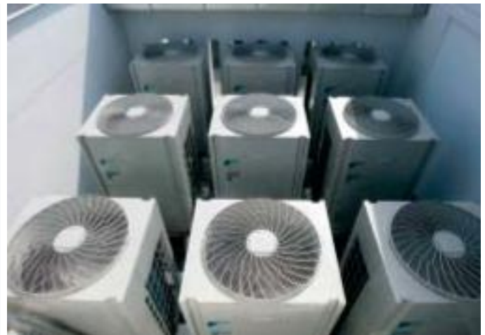
Bild 3: Aufstellung der Außeneinheiten
