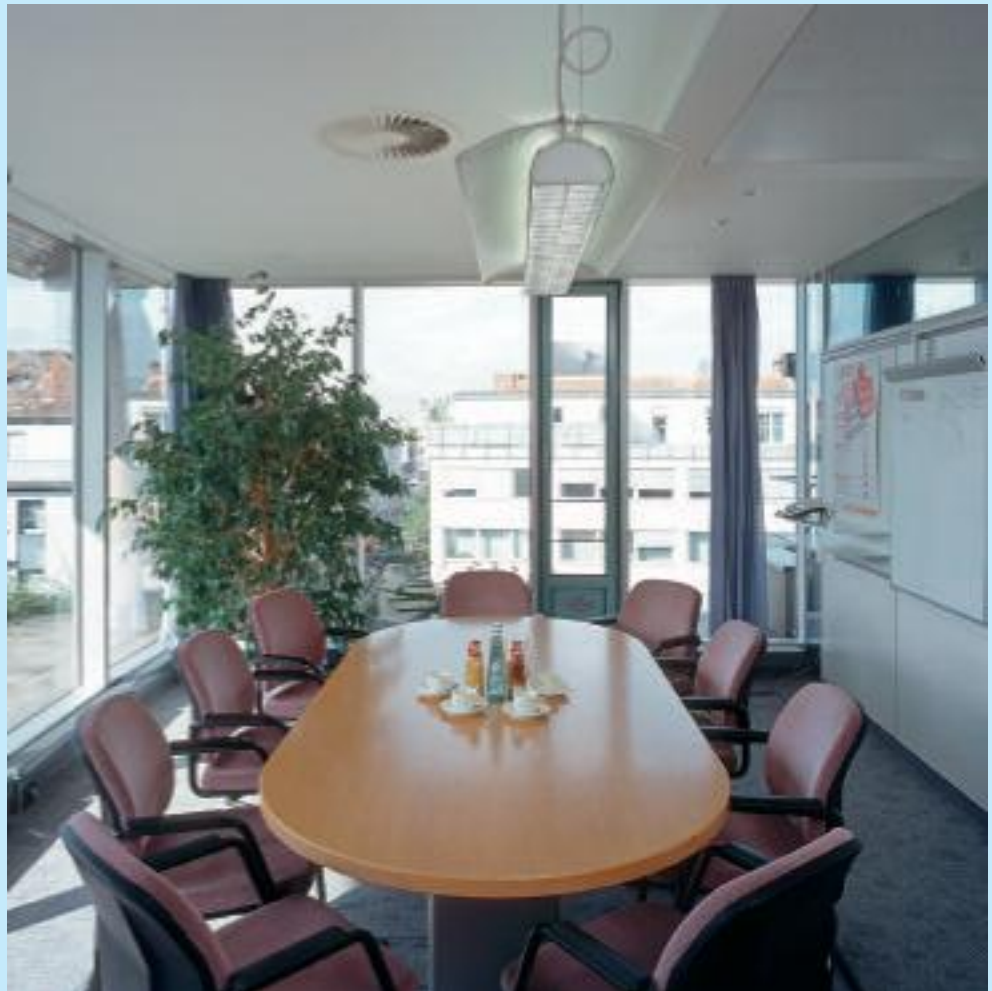
Kreisrunde Ausblasgitter an der Decke des Konferenzraumes: einziger Hinweis auf die erfolgte Klimatisierung.
